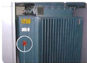
變壓器異常溫度偵測
