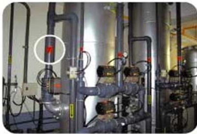
蒸汽管異常溫度偵測
