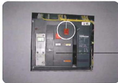
VCB過載異常溫度偵測
