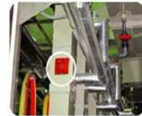
電鍍排廢汽管異常溫度例測 (上村按裝實例)
