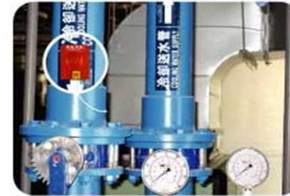
冰水機管路異常溫度偵測
