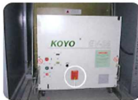
大型UPS異常溫度偵測
