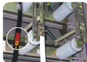
高壓大電纜異常溫度偵測
