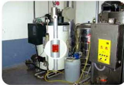
蒸汽管異常溫度偵測
