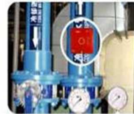
冷氣管異常溫度偵測 (上村按裝實例)
