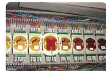
通信環控室異常溫度偵測
