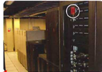
通信機房異常溫度偵測
