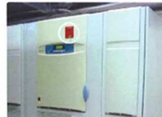
UPS房溫度偵測
