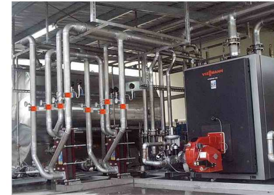
中央熱水系統機房管路溫度偵測
