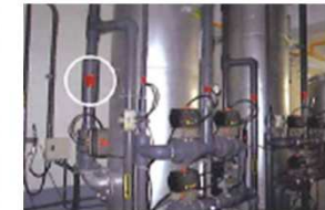
蒸氣鍋爐系統/管溫度偵測
